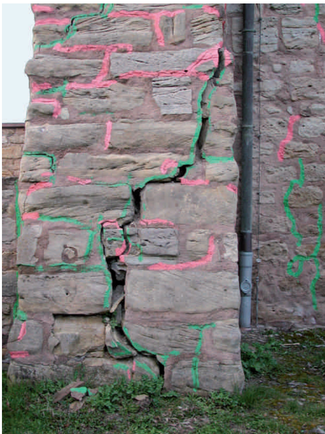
Abb. 7. Ettringittreiben nach Verpressung; Strebepfeiler Schloss Wiehe/Unstrut (Rissverlauf zu unterschiedlichen Zeitpunkten).
