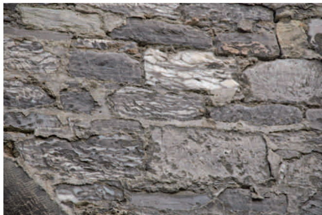
Abb. 5. Unverputztes Gipsmauerwerk, Burg Wendelstein/Unstrut.
