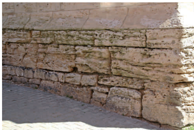
Abb. 6. Reliktstruktur – die ursprünglich glatte Oberfläche des Schaumkalks wurde durch Gipsbildung und anschließende Löseprozesse in ihrer ursprünglichen Ansicht (oberer Bildteil) verändert.
