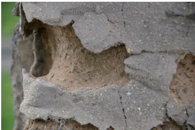
Abb. 4. Auflösung des Tuffsteingefüges im Fugenbereich.
