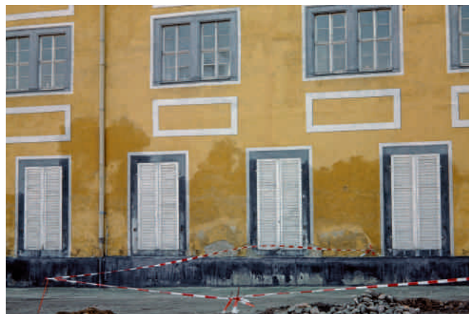
Abb. 3. Feuchtflecken bei hoher Luftfeuchtigkeit, Heidecksburg Rudolstadt.
